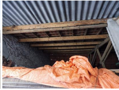
Indruk van het stalgedeelte met zicht op binnenzijde van het dak.
