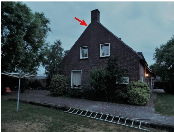
Fig.7. Verblijfplek onder dakpan
