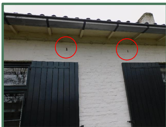
Open stootvoegen en vensters woonhuis
