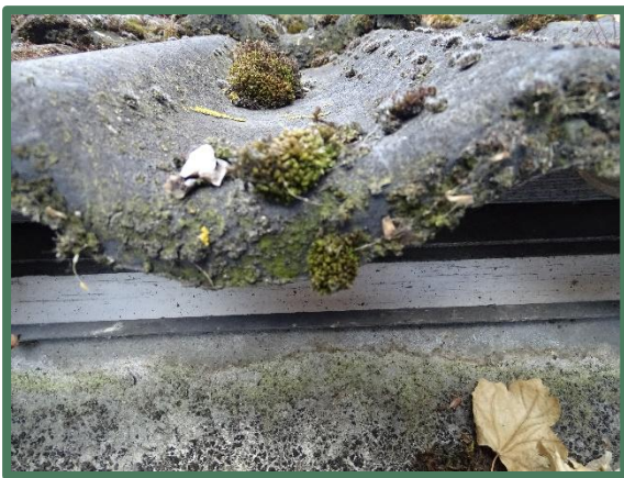
Foto 13: Achter de dakpannen dicht (tussengebouw).
