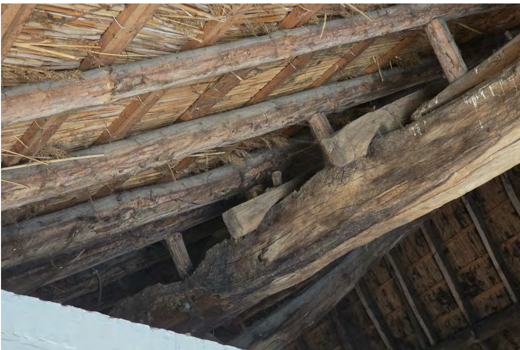
Sporen zijn gedeeltelijk nog met toognagels aan de gebintplaat bevestigd.
