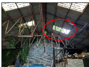
Figuur 11. Binnenzijde zuidwestelijk gelegen schuur met zicht op de missende dakplaat (rood omcirkeld).
