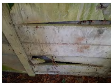
Figuur 6. Gaten tussen betonnen blokken in de noordoostelijk gelegen schuur.
