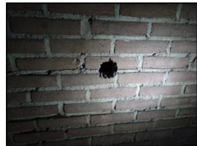
Figuur 20. Gat in de muur, gelegen op circa 1,5 meter boven de grond, die toegang verleent tot de spouw aan de binnenzijde in schuur 2.
