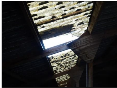
Figuur 7. Kapotte golfplaat van schuur 1.
