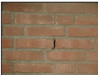
Figuur 21. Open stootvoeg, aanwezig aan de buitenkant van het gebouw direct ten westen van de onderzoekslocatie.
