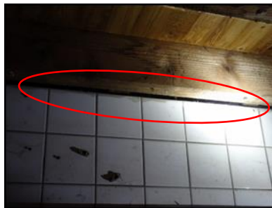
Figuur 19. Ruimte tussen tegels en betimmering (aangegeven met rode cirkel), aanwezig aan de binnenzijde van schuur 1.
