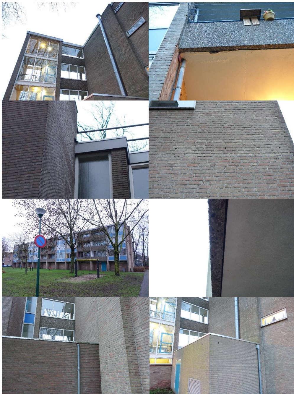
Figuur 6. Impressie appartementencomplexen met gevelpanelen die ruimte bieden, slecht aansluitende constructiedelen. En in de boiler ruimte (onderste twee foto's) openingen bij HWA en open stootvoegen.
