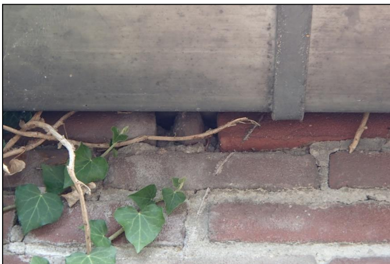
Figuur 9. Open stootvoegen die toegang geven tot de spouwmuur
