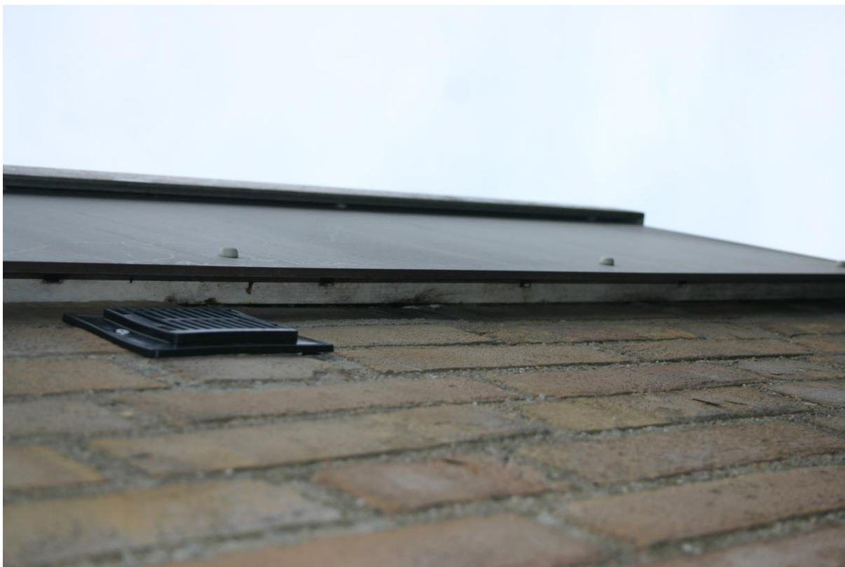
Figuur 4. Onder de dakbetimmeringen zijn geen kieren aanwezig.
