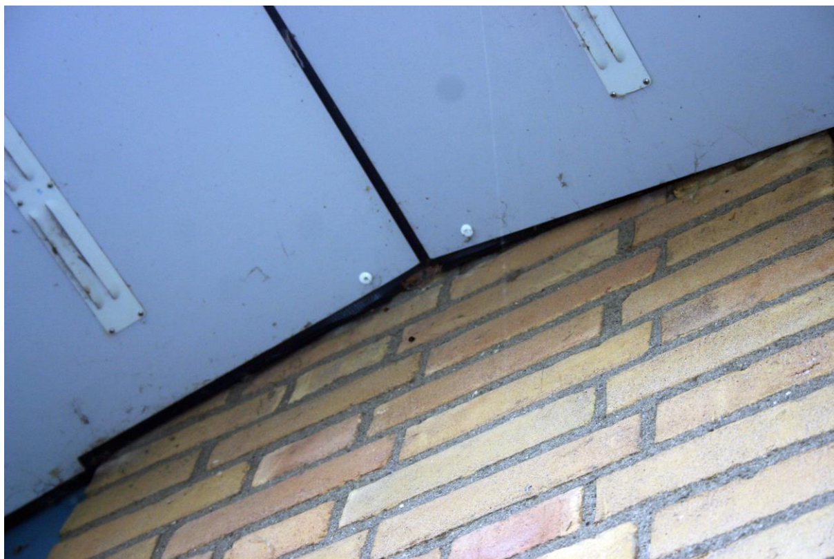
Figuur 3. De kier tussen de trespa dakoversteek en de gevel is afgedicht met strips van kunststof.
