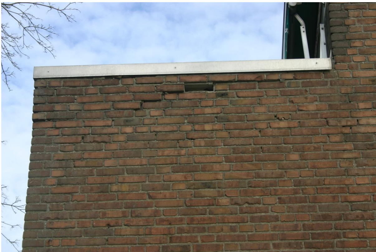
Figuur 3. Grote beschadiging aan de zuidelijkste kopgevel.
