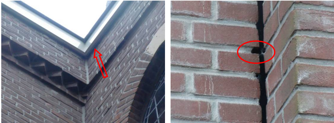
Figuur 9. Links: ruimte tussen muur en gootbetimmering. Gat in hoek van twee muren.
