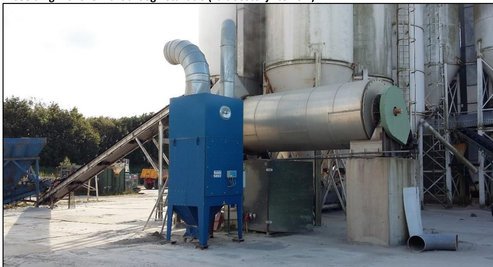
Afbeelding 4.6: overzicht drooginstallatie (zuidoostelijk terrein)
