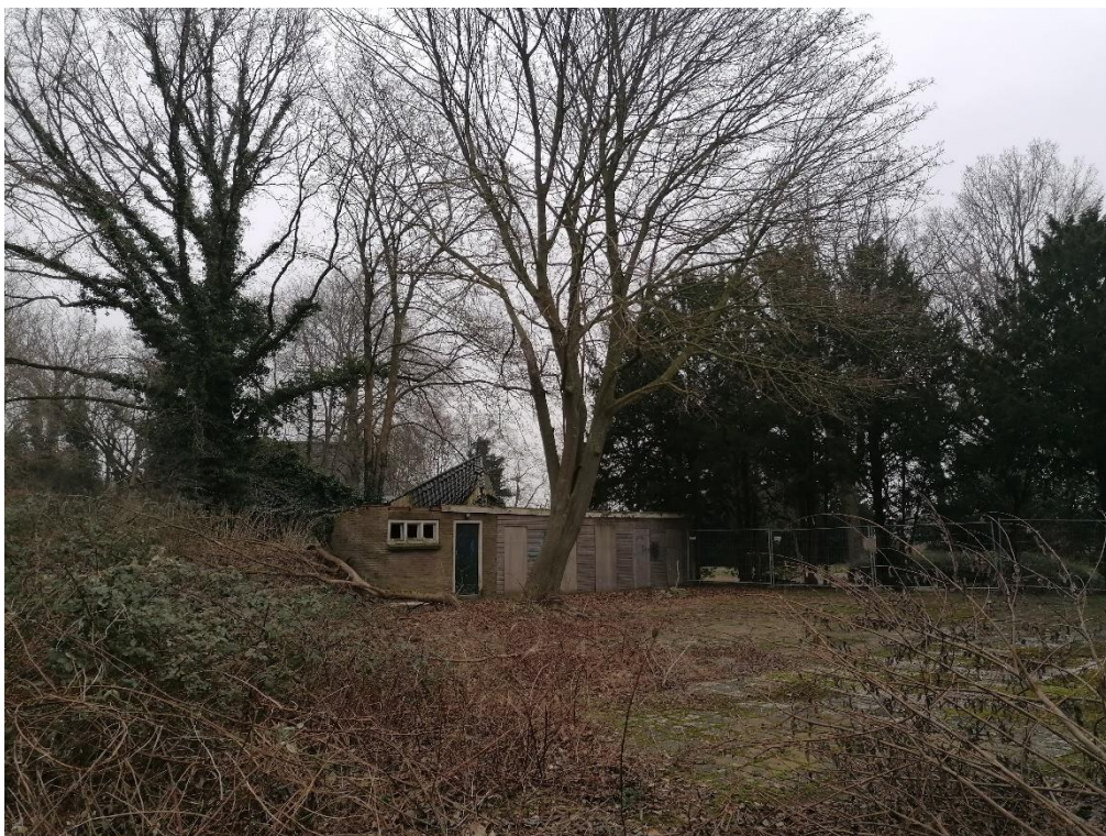
Foto 8. Oude schuurtjes aan de achterzijde van het Raadshuis. Op de voorgrond is alles verhard en links op de foto is de overwoekering van braam te zien. Het geraamte van een dak op de achtergrond is het vervallen dak van de oude brandweergarage te zien.
