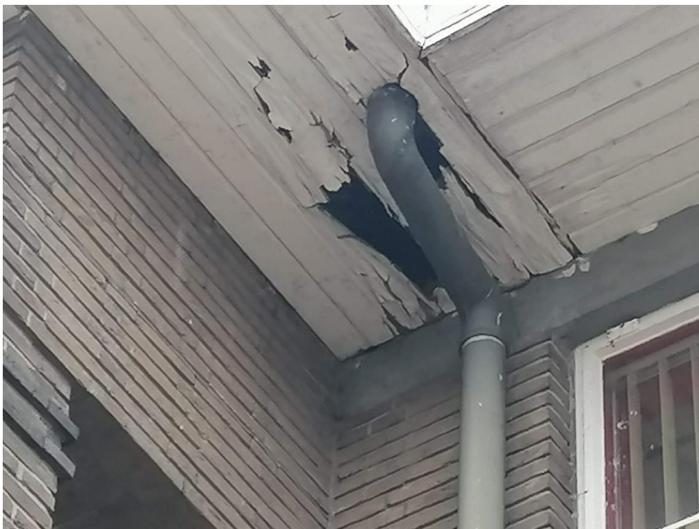
Foto 3. Close-up van de dakrand waarbij de gaten en rottende planken duidelijk te zien zijn. Via deze openingen krijgen vogels en mogelijk vleermuizen toegang krijgen tot de achtergelegen ruimte.
