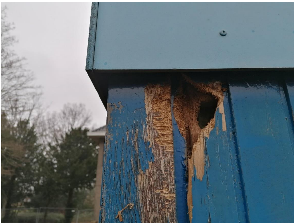
Foto 7. Gat aan de linkerachterzijde van de aanbouw. Mogelijk gemaakt door bruine rat.
