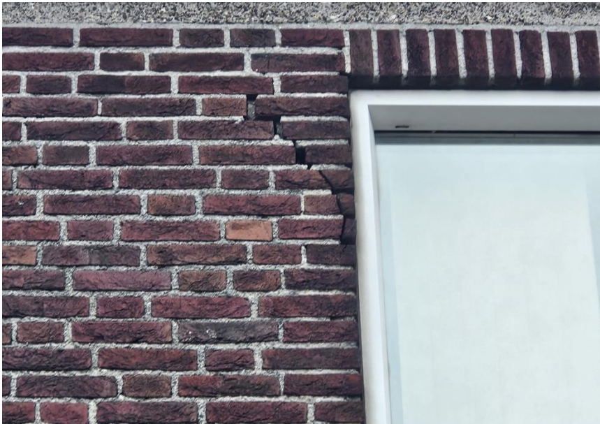
Figuur 12: Scheur in voorgevel slagerij
