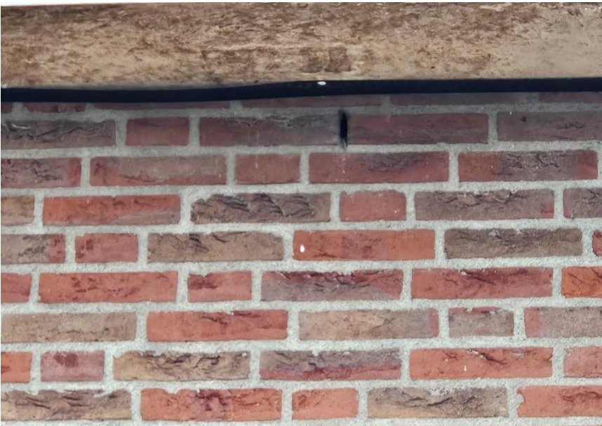
Figuur 13: Open stootvoeg noordelijke gevel supermarkt
