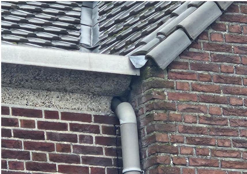
Figuur 14: Opening bij regenpijp en loodslab en overhellende dakpan slagerij
