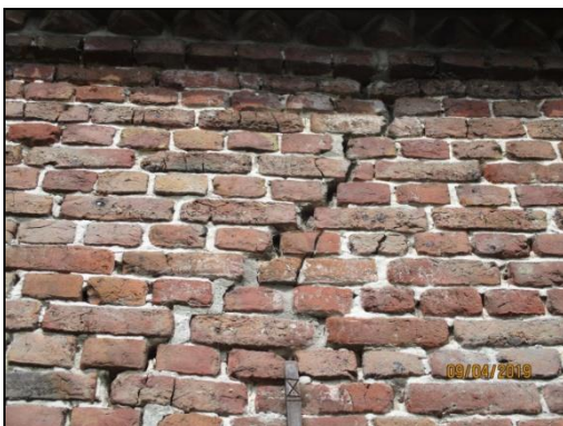
Scheuren metselwerk zuidgevel
