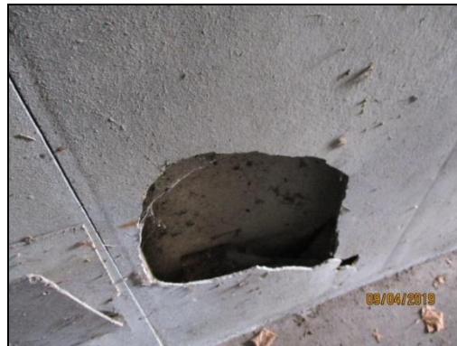
Schade aan mogelijk asbesthoudend materiaal
