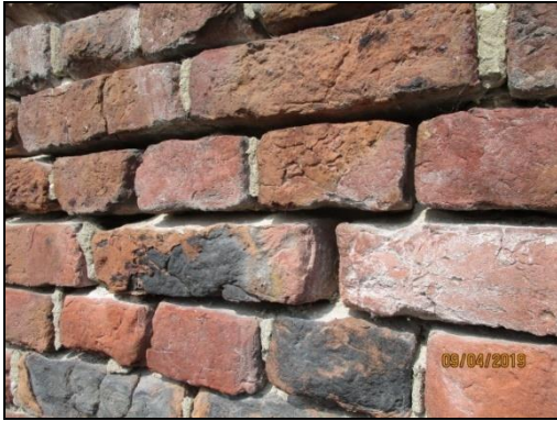
Uitgesleten voegwerk zuidgevel
