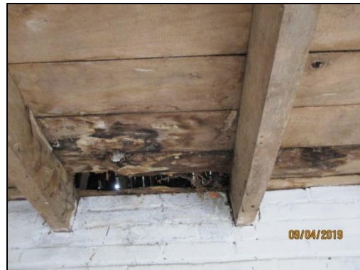
Aantasting houtwerk vloerdelen
