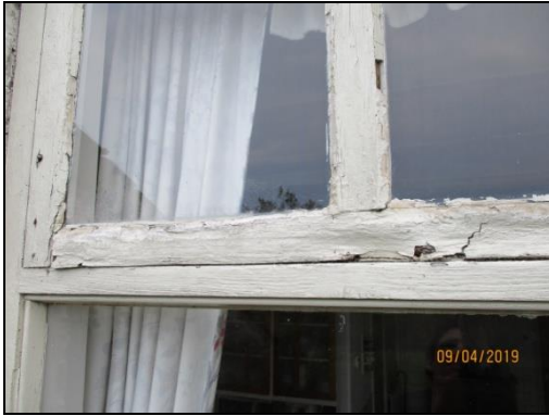
Slecht schilderwerk en houtrot gevelkozijn noordgevel (t.p.v. keuken)
