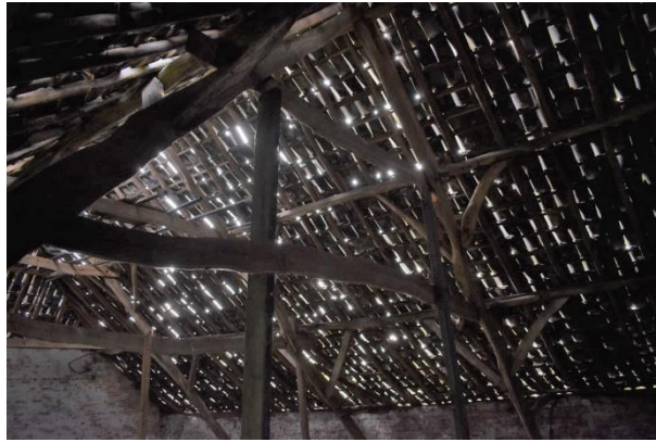
Versterkt spant boven het bedrijfsgedeelte.
