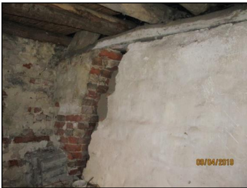
Scheuren in het metselwerk dragende scheidingswand
