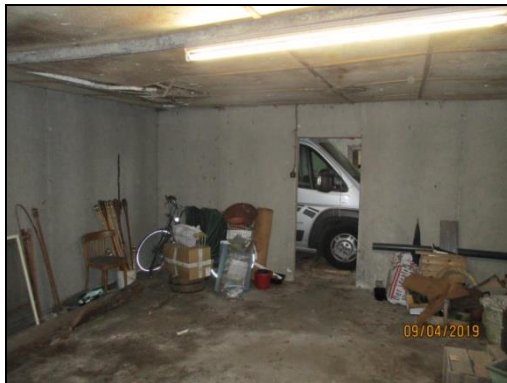
Aftimmering met mogelijk asbesthoudend materiaal
