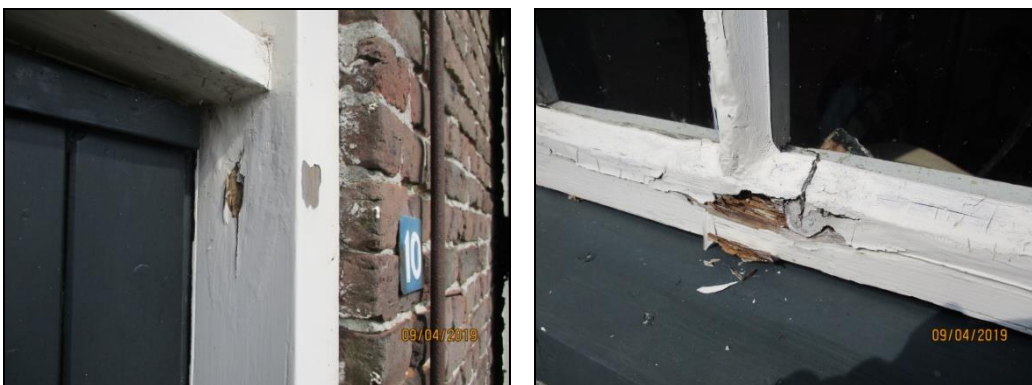
Houtrot deurkozijn zuidgevel
