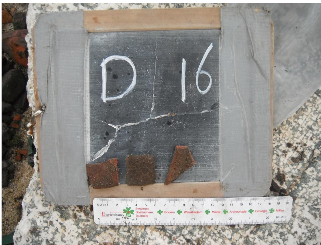
Foto 18. Asbestverdacht materiaal in asbestinspectiegat D16
