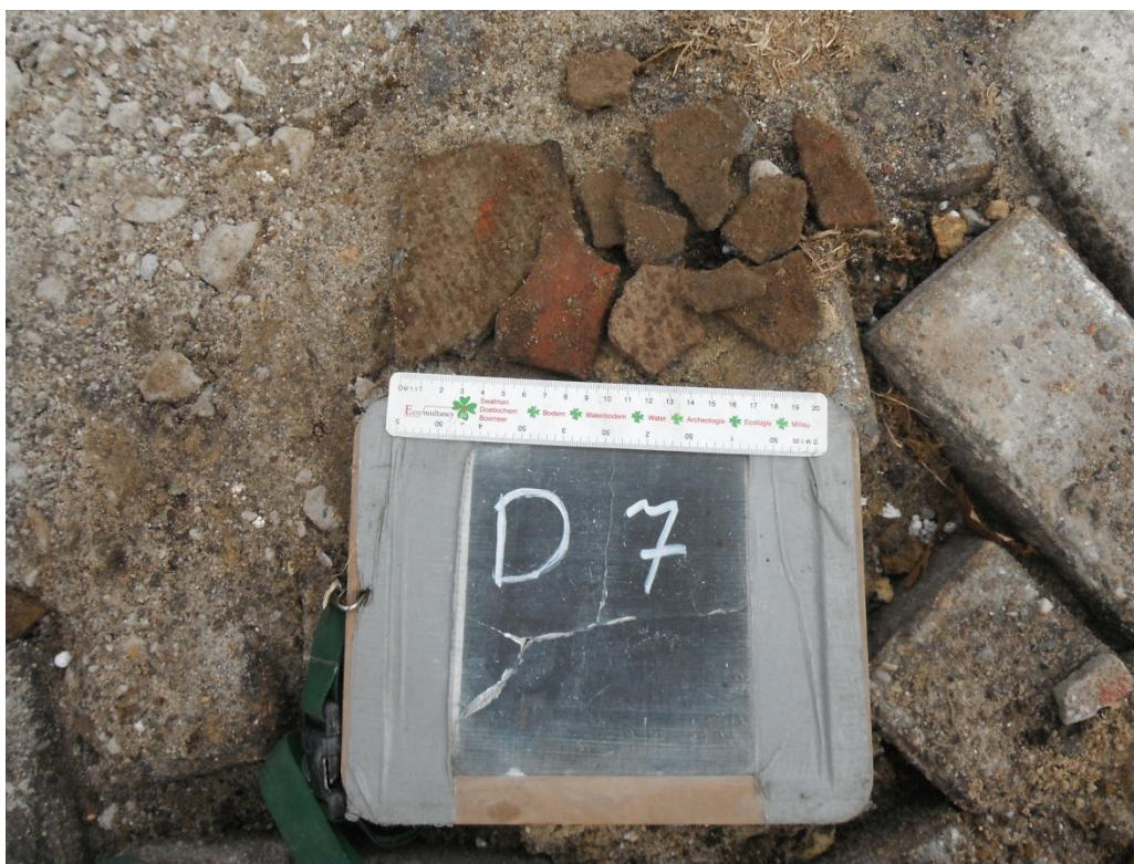
Foto 8. Asbestverdacht materiaal in asbestinspectiegat D07
