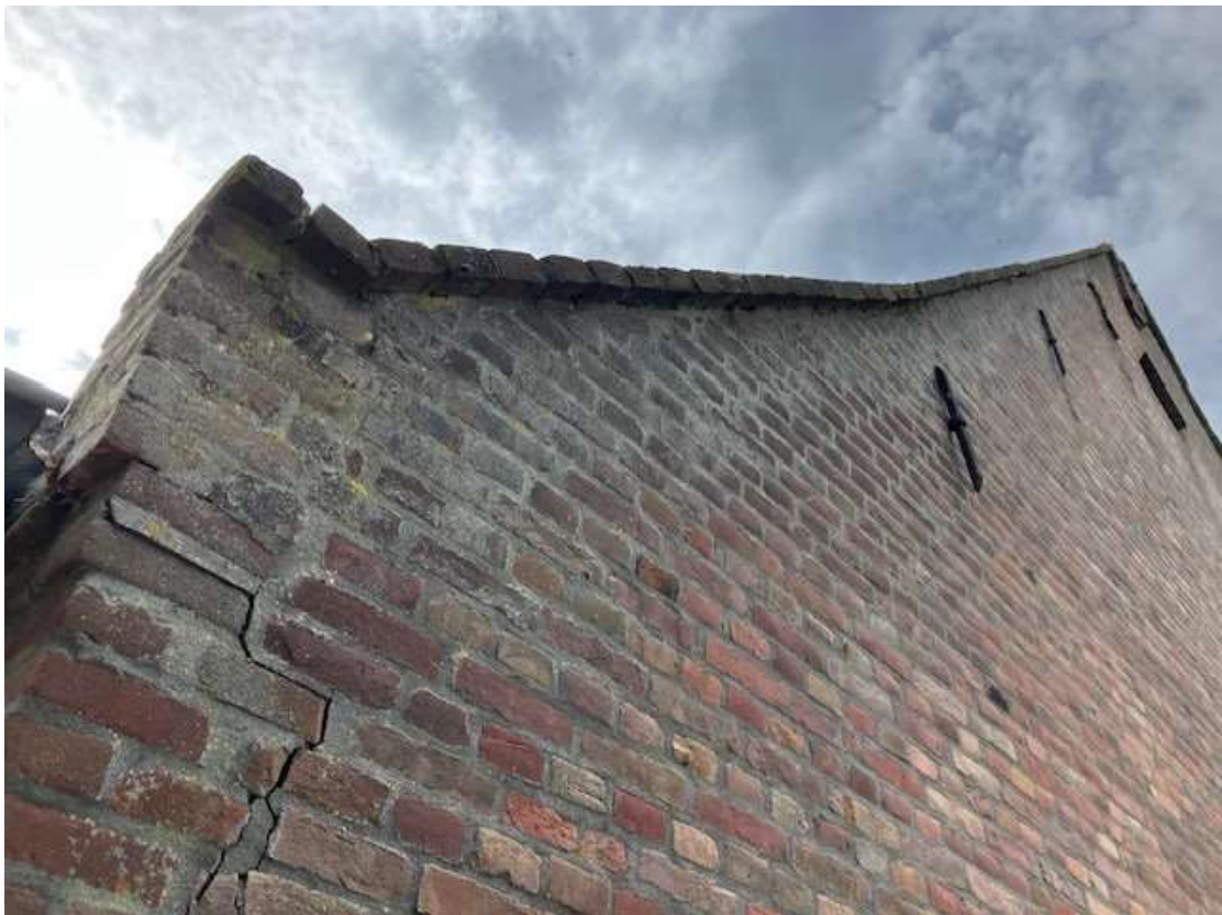
• Afbeelding 9: Dakaansluiting is dicht, zijn steense muren dus gesloten
