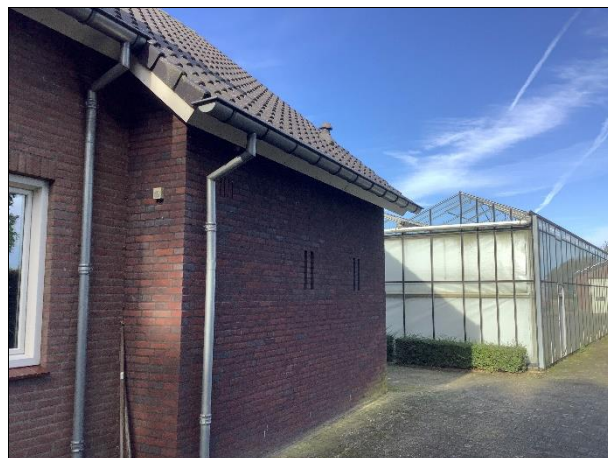
Foto 2 Open stootvoegen (nabij de rechter regenpijp) in de bedrijfswoning op de onderzoekslocatie,
