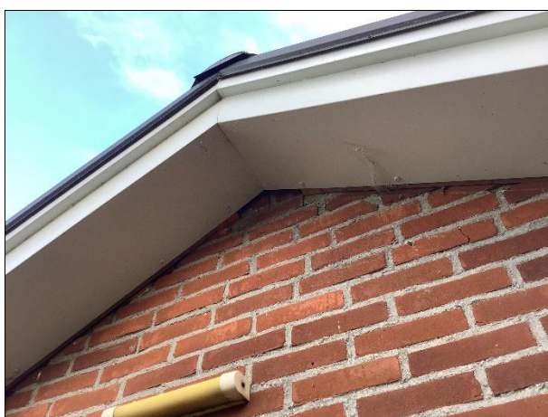
Foto 5 De niet nauw aansluitende boeiborden bij de oostelijke gevel van de garage.
