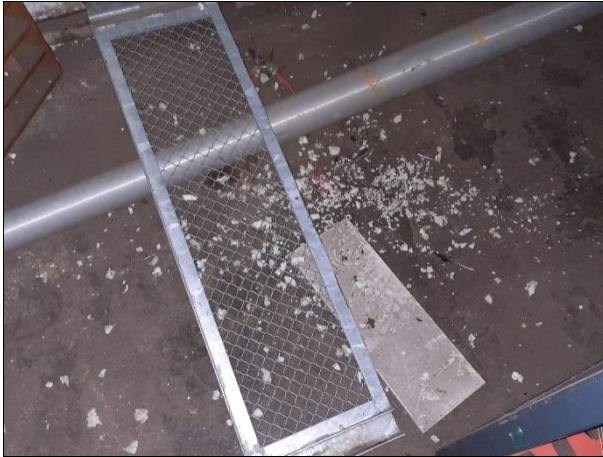
Foto 7 Stukken isolatiemateriaal met veren in de loods op de onderzoekslocatie.
