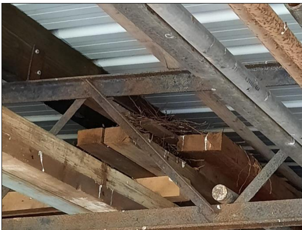
Foto 9 Duivenest op de balken in de aanbouw ten noorden van de loods.
