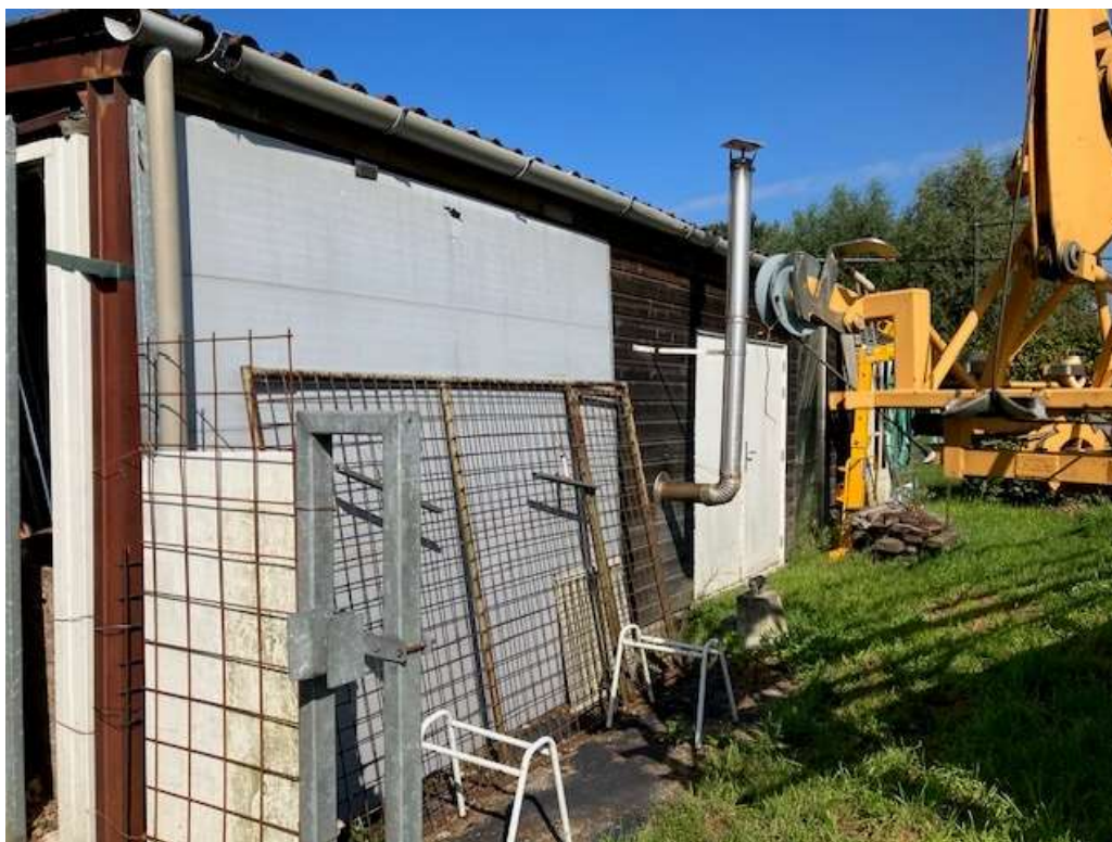
• Afbeelding 13: Achtergevel te slopen aanbouw aan bijgebouw
