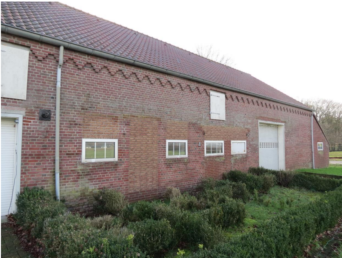
Afb.2. Rechter deel van de voorgevel. Het muurwerk toont sporen van gewijzigde vensters en deuren.
