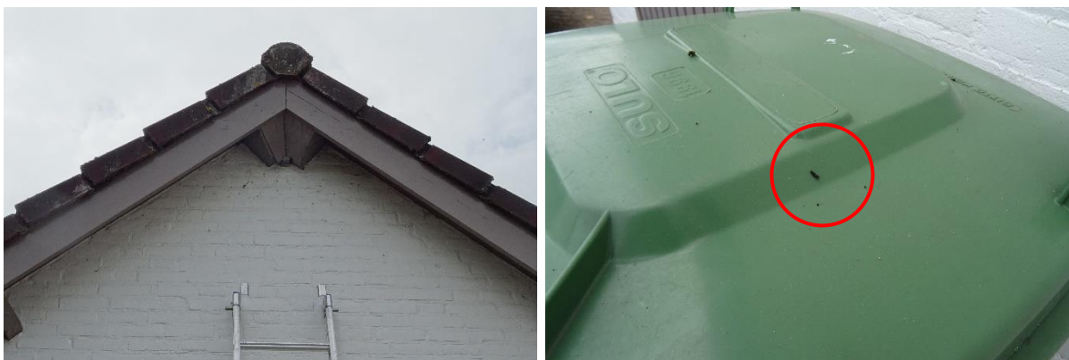
Afbeelding 15 t/m 18: aanwezige sporen van vleermuizen tegen de kopgevel van de garage. Bron: Rik Bijvelds. Datum: 15-06-2021
