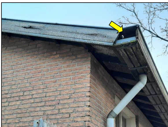
Figuur 10. Opening langs dakrand aan voorzijde gebouw.
