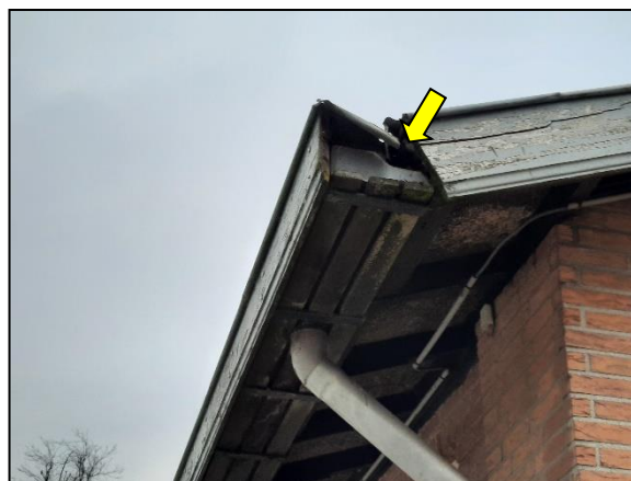
Figuur 11. Opening langs dakrand aan achterzijde gebouw.
