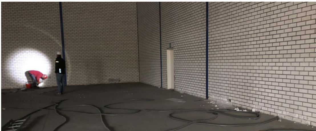
Figuur 25: meerdere steekproefgaten door de gehele ruimte zijn geïnspecteerd. Deze spouwdelen zijn echter alleen voorzien van isolatiemateriaal.
