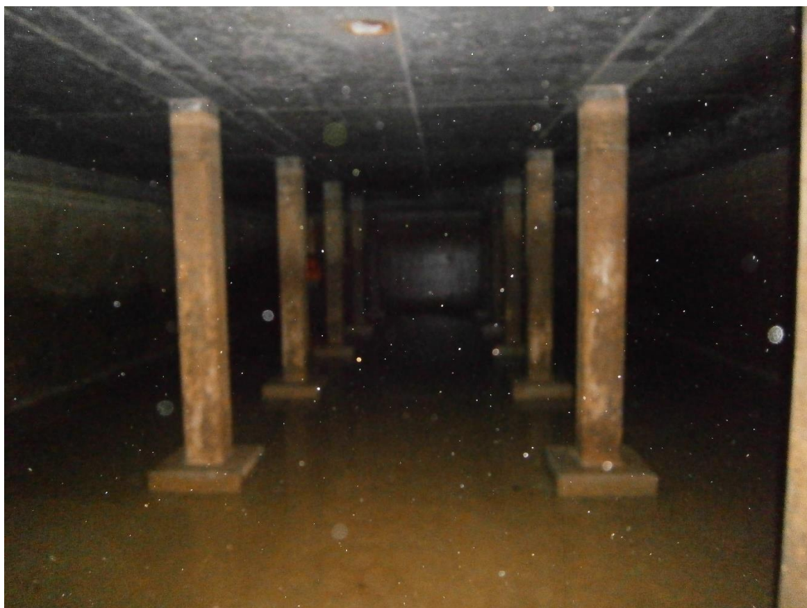
Afb.22. Interieur van de westelijke reinwaterkelder.
