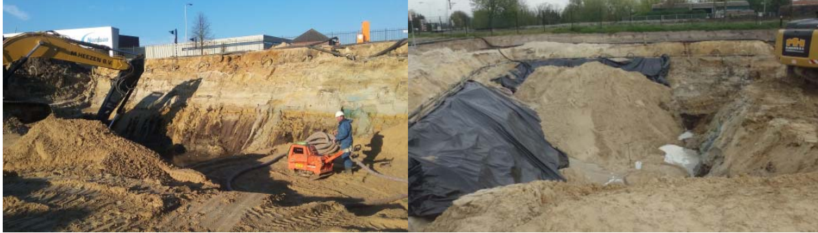
Figuur 3.2: restverontreiniging westelijke perceelgrens en aangebracht folie ter plaatse.
