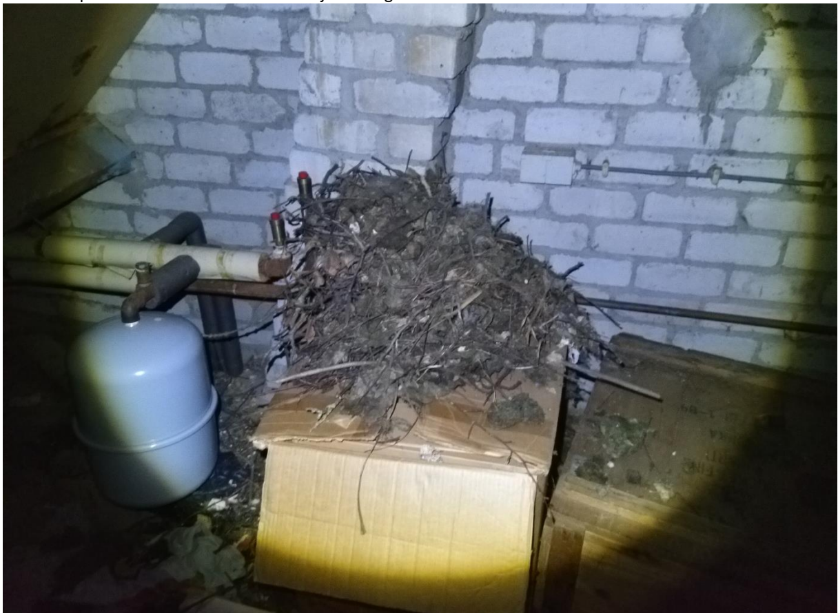
Foto 6: Het vogelnest op de zolder van de bedrijfswoning.
