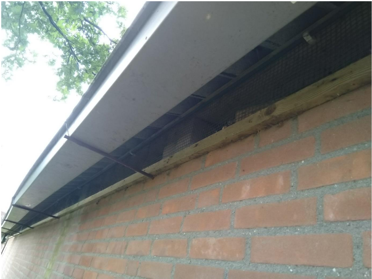
Foto 9: De ventilatie opening bovenaan de oost- en westgevels van de stal welke is afgedicht met kippen gaas.
