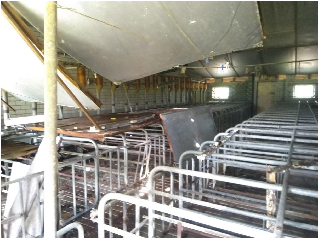
Foto 11: Impressie van de binnenzijde van de varkensstal met het loshangende dakbeschot op de voorgrond.
