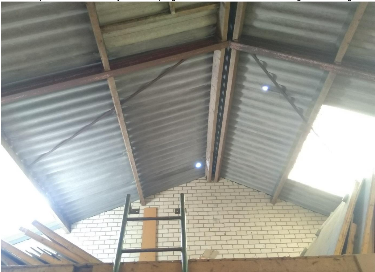
Foto 18: Impressie van de zolder met links het kapotte dak en vloering in de opslagschuur.
