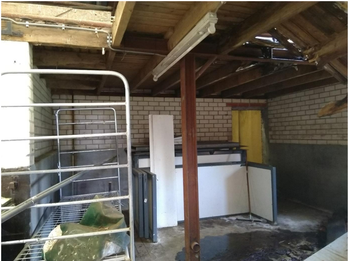
Foto 17: Impressie van de binnenzijde van de opslagschuur met aan de rechterkant de ingestorte vloering.
