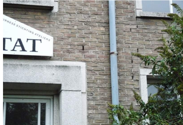
Figuur 6: Detail van foto 3, open stootvoegen in de zuidzijde van schoolgebouw 1. Foto genomen in noordelijke richting.
