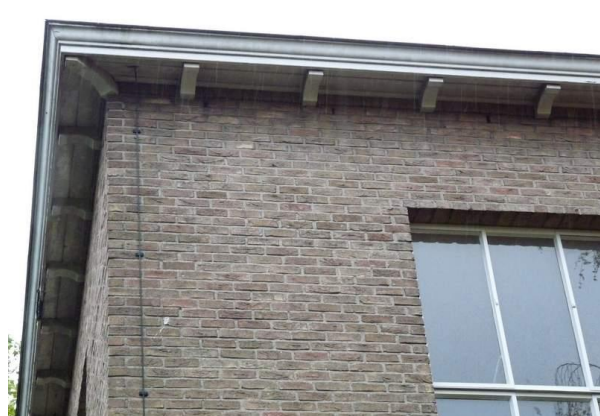
Figuur 16. Detail van dakrand van schoolgebouw 1, aan de zuidoostelijke zijde. Onder de dakrand open stootvoegen (de langerekte dunne strepen zijn vallende regendruppels). Foto genomen in zuidwestelijke richting.
