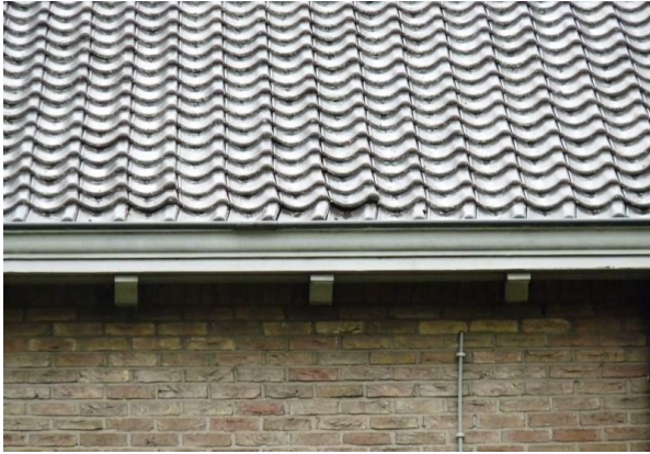
Figuur 5: Detail van foto 3, het dak van een deel van schoolgebouw 1, met losliggende dakpannen. Foto genomen in westelijke richting. Foto genomen in noordelijke richting
