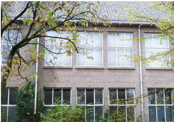
Fig. 11. Detail van de zuidzijde van schoolgebouw 2, open stootvoegen tussen de raampartijen. Foto genomen in noordelijke richting.
