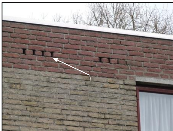
Figuur 9. Open stootvoegen hotelgebouw waarbij uitvliegers zijn waargenomen.
