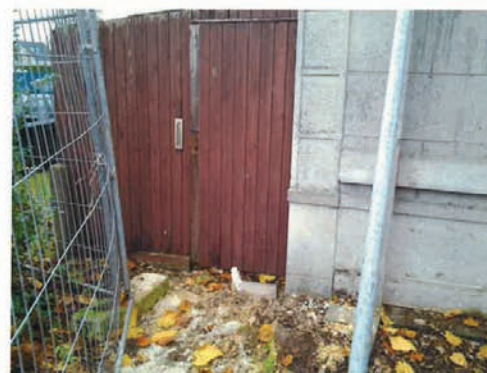
foto's onderzoekslocatie 11-11-2013 (aangetroffen ontluuchtingspijp)
