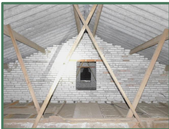
Zolderruimte boven koelcellen
