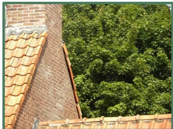
Foto 24: Kantpannen van de woning open aan de zijgevels.
