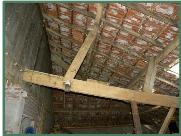
Foto 20: Onbeschoten dak van de schuur.
