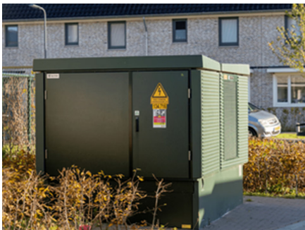
Voorbeeld trafo Enexis
