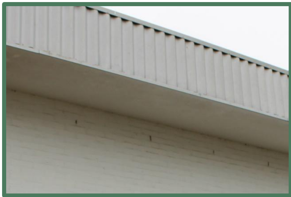
Foto 21: Strak aangesloten overstek voormalige autogarage.
