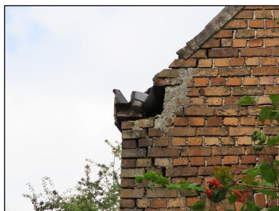
Foto B: verweerde voegen en opening oostzijde
