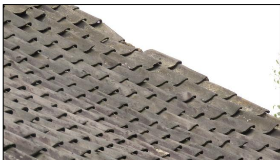
Foto A: Opening onder dakpannen
