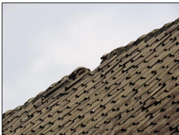
Foto C: Missende dakpannen aan de zuidzijde van de woning.
