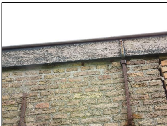
Foto G: Ruimte onder betimmering en open stootvoeg
