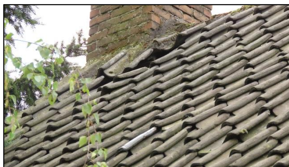
Foto B: Opening onder dakpannen
