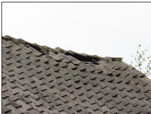
Foto A: Missende dakpannen aan de noordzijde van de woning
