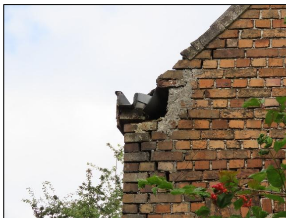
Foto D: Gat achter regenpijp
