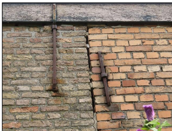
Foto D: spleet tussen muren zuidzijde.
