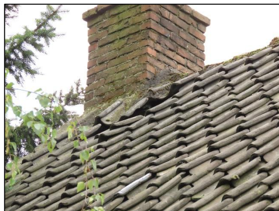
Foto B: Missende dakpannen aan de noordzijde van de woning
