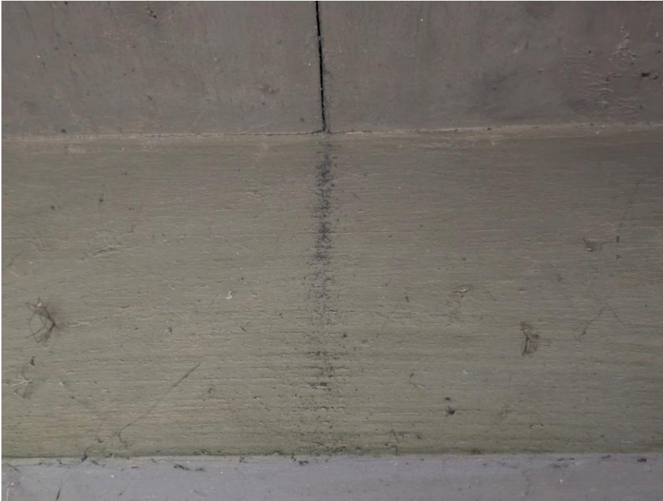
Stofdoorslag vanaf de zolder door een naad in de vloer. Stofspoor op de vloerbalk in de opkamer.
