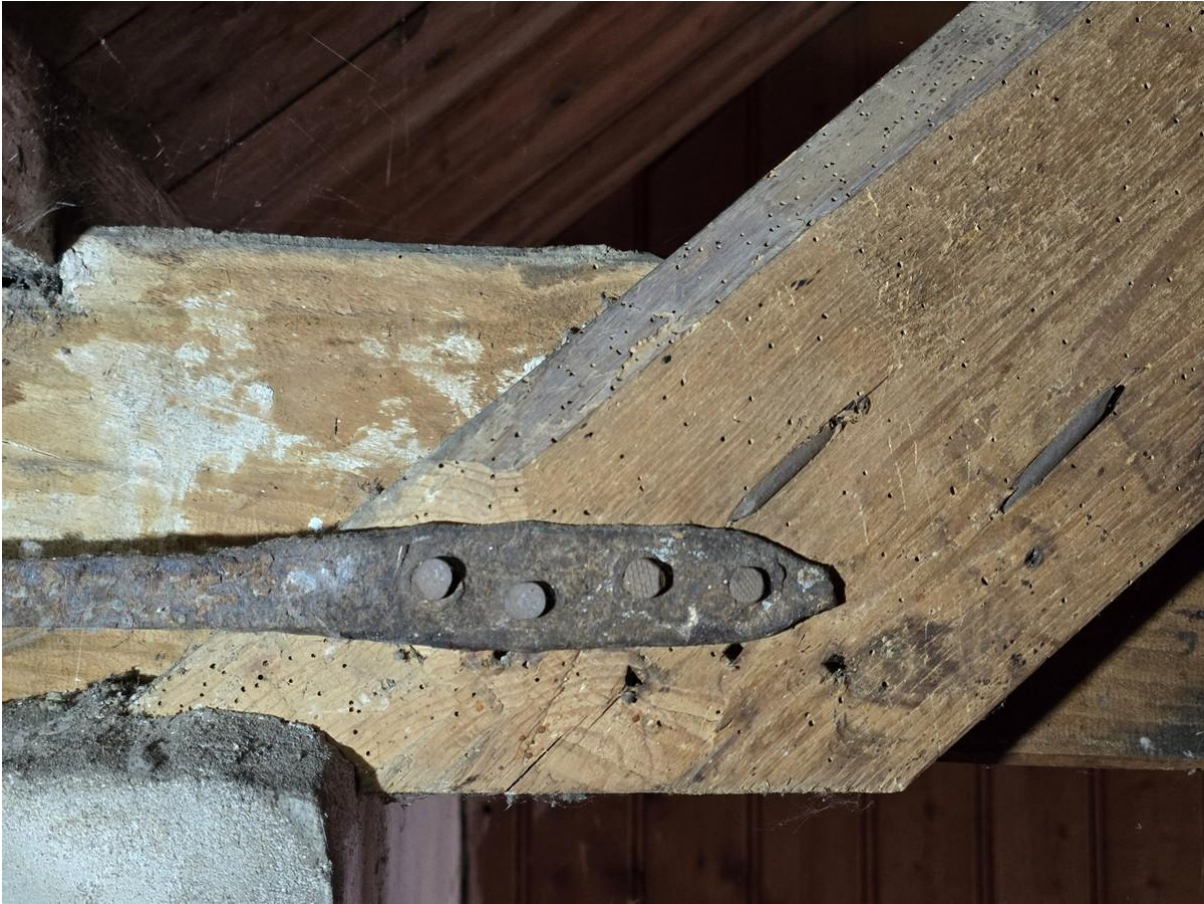
In 1938 is een bestaand anker opnieuw vastgezet aan het spantbeen. Ook hier zien we dat de draadnagels waarmee het blokken is vastgezet aan het spantbeen door en om zijn geslagen.
