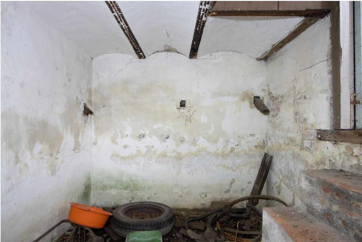
De kelder in de richting van de voorgevel. Legplanken zijn verdwenen, balkjes ten behoeve van die plankjes resteren.
