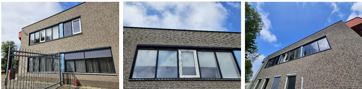
Afbeelding 4: Stootvoegen stenen kantoorgebouw
