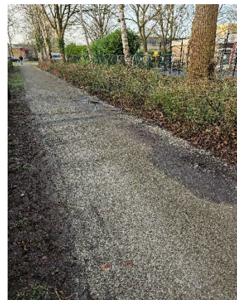
Afbeelding 11: aanwezig opdruk van het fietspad nabij boom 137
