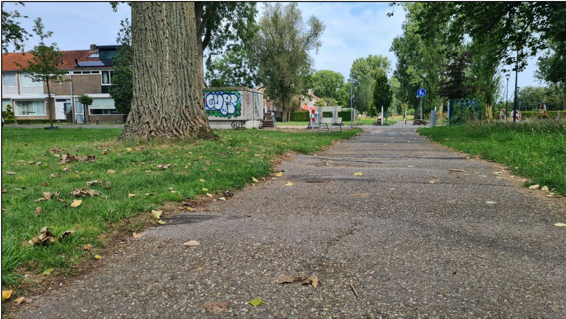
Afbeelding 11: Boom 86 drukt op grote schaal het asfalt omhoog van het fietspad.
