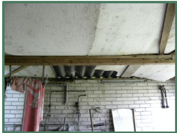
Foto 20: Vervallen dakisolatie met vochtschade.
