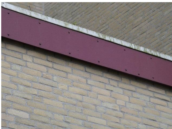
Foto 3: openstaand boeiboord welke mogelijk toegang biedt tot de spouw, waar vleermuizen hun verblijf kunnen vestigen.
