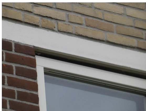
Foto 6: openstaande trim welke mogelijk toegang biedt, waar vleermuizen hun verblijf kunnen vestigen.
