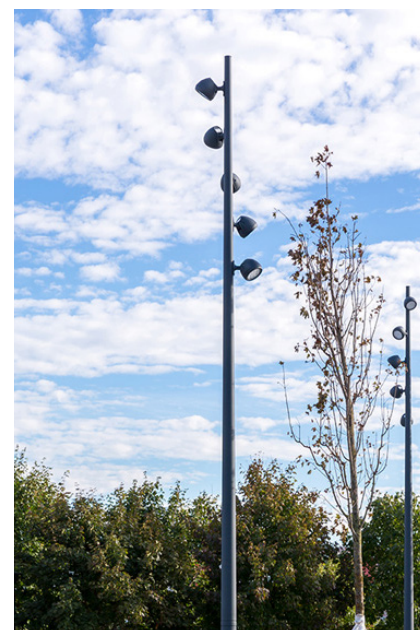
Mast met spots bij verbreding trottoir (entree parkeergarage), type Eclatec
