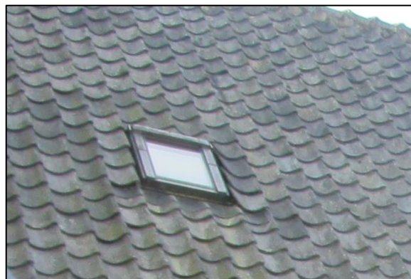
Foto B: Openingen onder dakpannen
