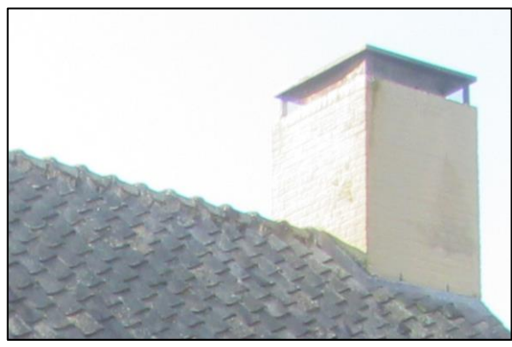
Foto D: Open stootvoegen schoorsteen hoofdgebouw
