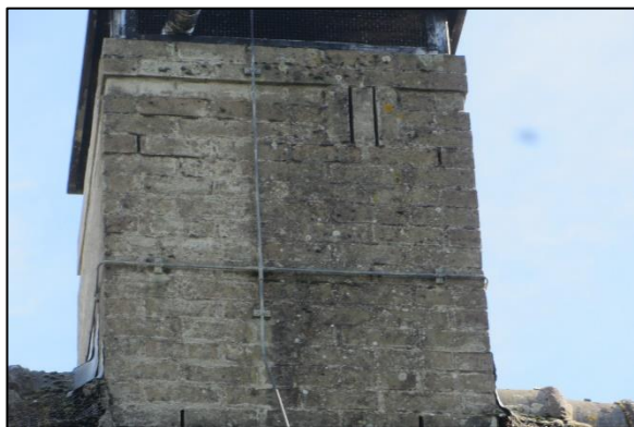
Foto A: Open stootvoegen schoorsteen schuur
