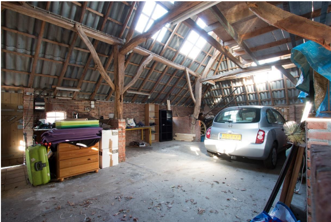
De kleine Vlaamse schuur met eikenhouten draagconstructie is zonder twijfel ouder dan de grote Vlaamse schuur. Omdat er in de twintigste eeuw vee heeft gestaan, is de constructie behoorlijk aangetast.
