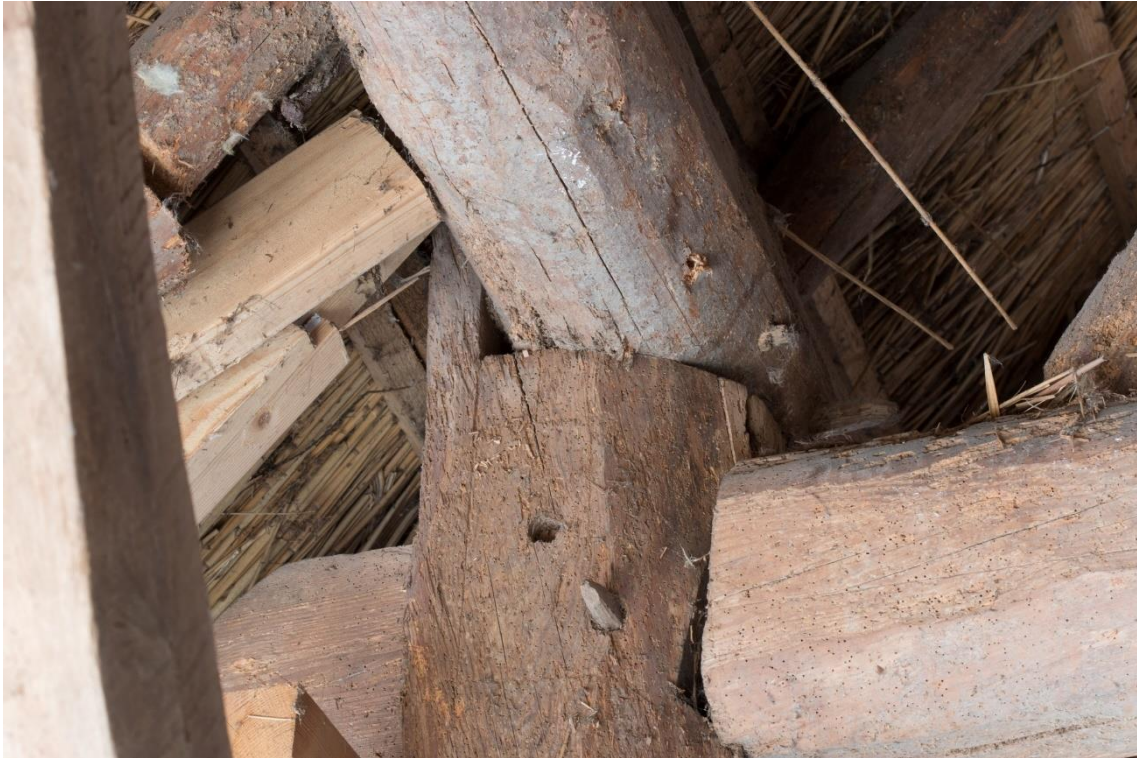
De verbinding van de gebintstijl op de gebintplaat aan de zuidzijde. De stijl is met twee pennen uitgevoerd, waarvan er één in de gebintplaat steekt. De verbinding is niet erg strak, waardoor er even aan gedacht is dat de gebintplaten een keer vernieuwd zijn. Dit kon echter niet concreet worden gemaakt. Ook de aansluiting van de gebintbalk op de gebintstijl oogt overigens weinig strak (en is een tegenargument).
