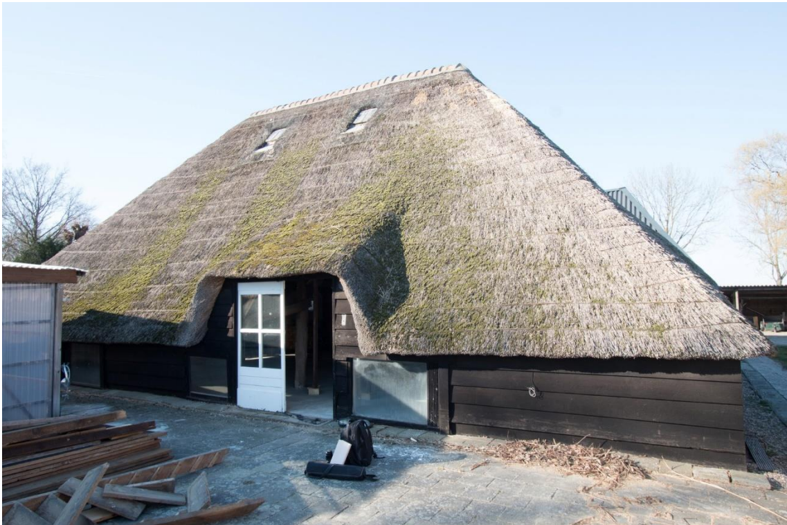
De lange wand is in het laatste kwart van de twintigste eeuw volledig vernieuwd. De dakraampjes zullen ook toen zijn aangebracht. Nog wat later is een deel van het dak opgelicht om openslaande deuren te realiseren. Door de wanddelen strak en regelmatig te zagen, is het oorspronkelijke karakter behoorlijk aangetast.
