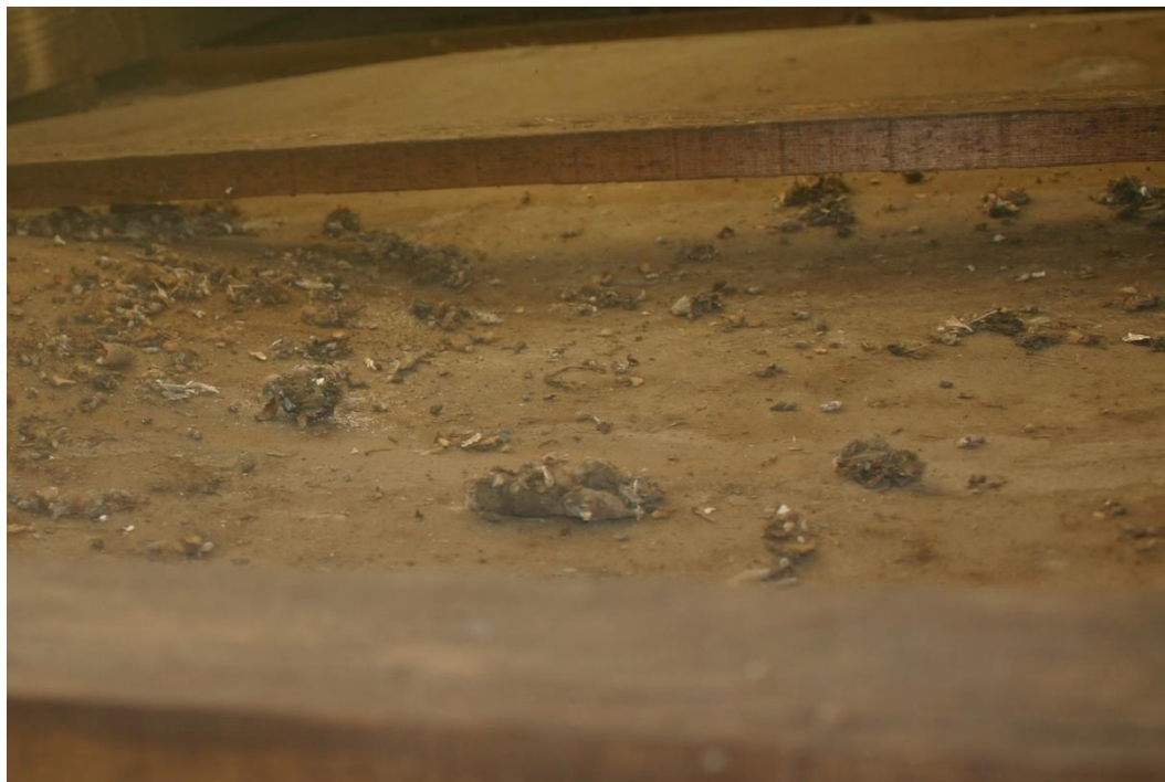
Figuur 4.4.5. Op het geïnspecteerde dakbeschot lagen enkele zeer oude steenmarteruitwerpselen.
