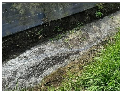
Figuur 16. Vervuild water in zuidwestelijk gelegen afwateringskanaal.
