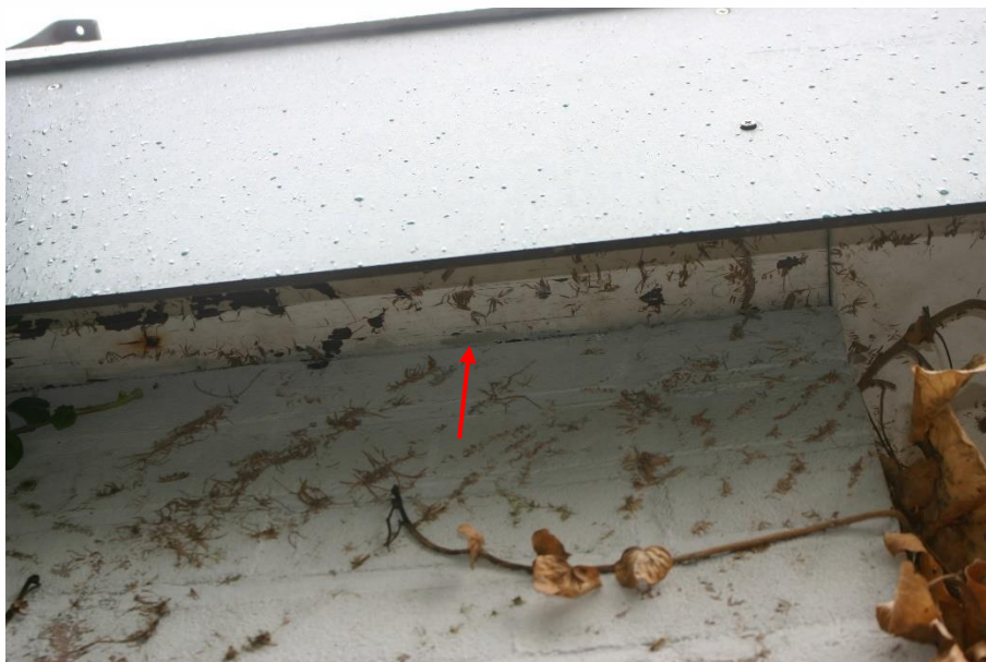
Figuur 4.4.2. Het dakoverstek kiert met de gevel (rode pijl), waardoor vleermuizen hier het gebouw binnen kunnen.
