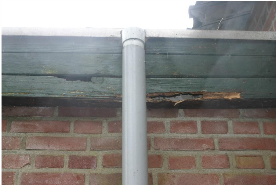
Figuur 4.4.1. De boeiboorden zijn op verschillende plaatsen rot, waardoor vleermuizen de achterliggende ruimte en de spouw kunnen bereiken.
