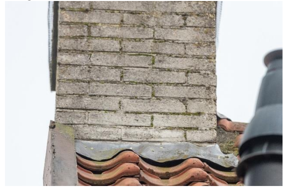
openstaande loodflappen geven toegang voor vleermuizen om een verblijf te vestigen.
