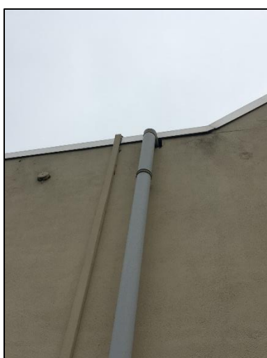
Foto 3. Opening bij de ingang van de regenpijp in de muur van het kantoorpand
