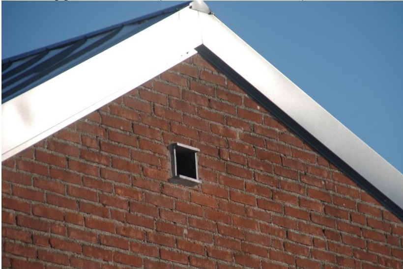
invlieg gat kerkuil in de kopgevel van de loods
